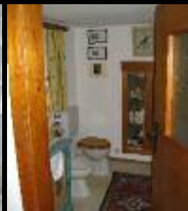
Der ursprüngliche Zustand entsprach zwar keinesfalls modernen Wohnvorstellungen, verfügte aber bis auf eine feuchte Wandstelle nahe des Eingangs über eine gute Bausubstanz.
