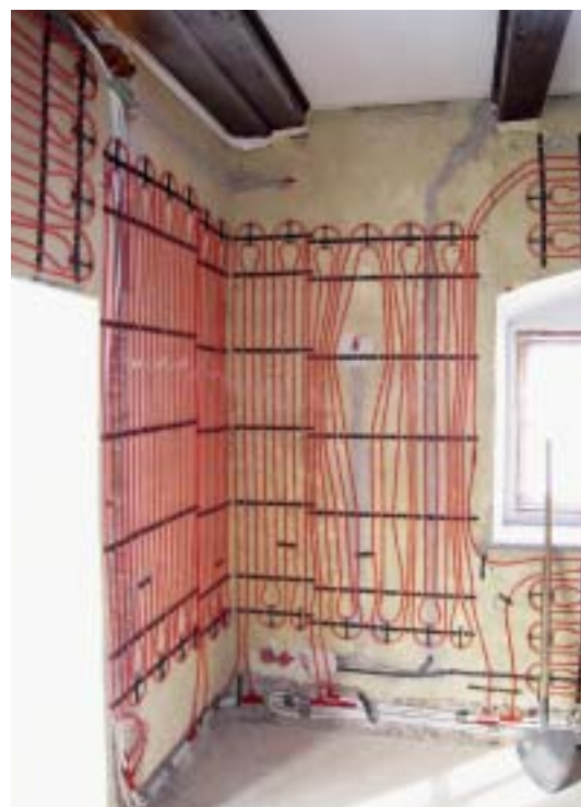
Gutes Raumklima: Im gesamten Haus wurden Wandheizungen installiert, so dass der Raum frei von Heizkörpern bleibt
